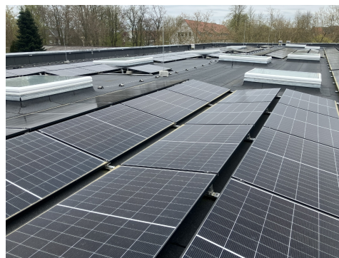
Abbildung 8: Foto der additiven Dach-PV. © Thorsten Kühn, HZB
